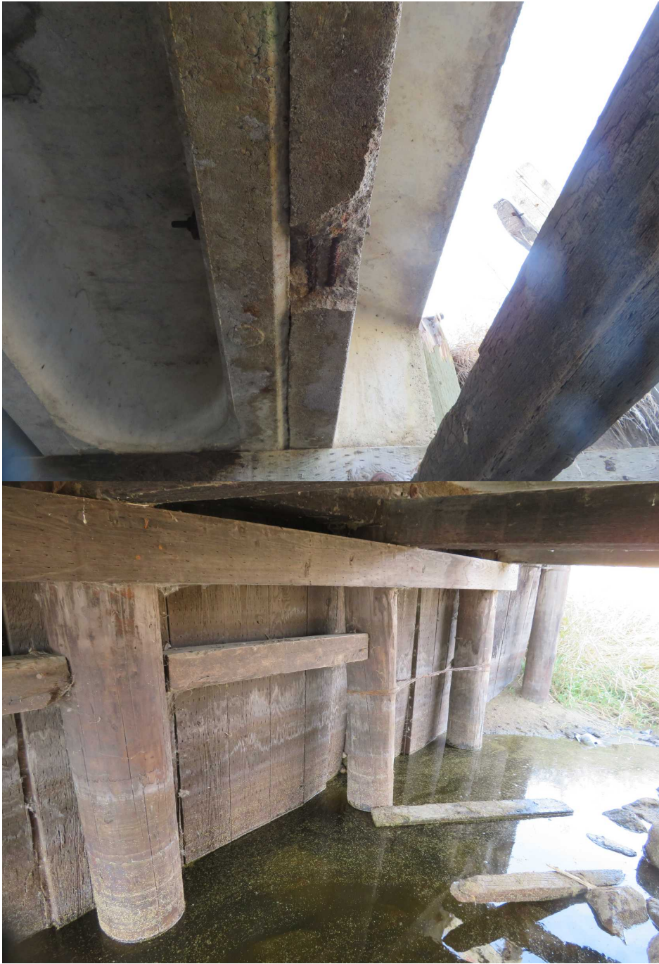
9. N/E curb unit spall
